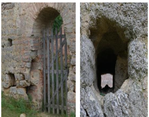
Trous pour les poutres de blocage ouverture de la porte et trous d'ancrage des poutres plancher
